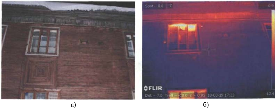
Рисунок 2 – Потери тепла в зоне деревянной обшивки карниза (обшивка вагонкой)
