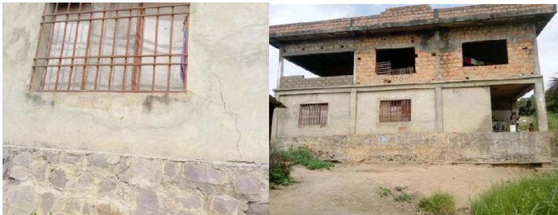
Photo 4–Fissuration des suites d’un tassement provoqué par un glissement de terre dans la zone érodée de Mataba 2 dans la commune de Ngaliema à Kinshasa
