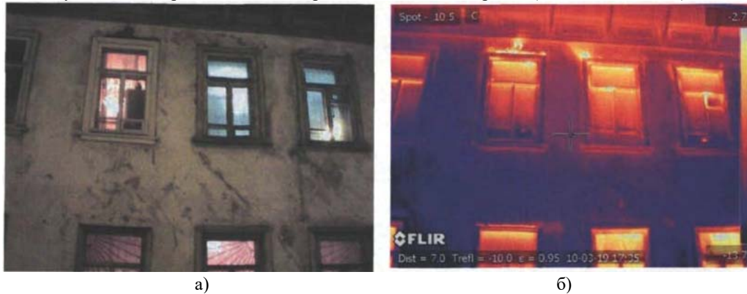
Рисунок 3 – Потери тепла деревянного оштукатуренного здания.
