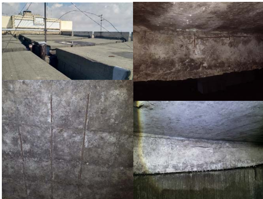
Рисунок 3- Дефекты и повреждения несущих элементов крыши
