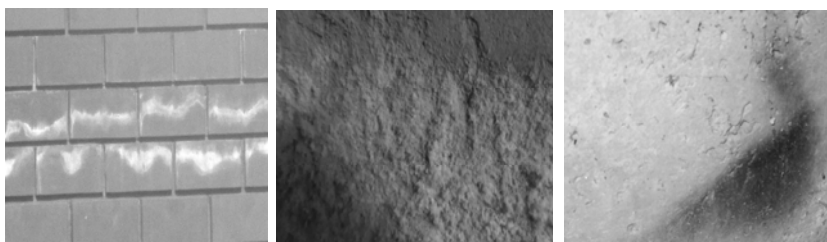
Рис. 1. Высолы (слева направо) на кирпичной кладке, бетонных стенах, участки плесени на бетонных стенах
